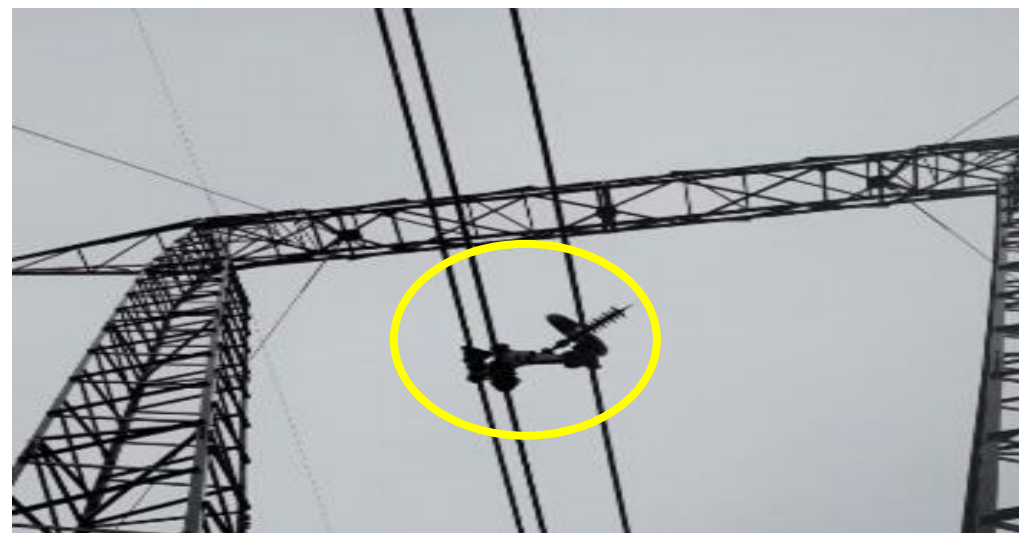
Rompimento do isolador na estrutura 814
