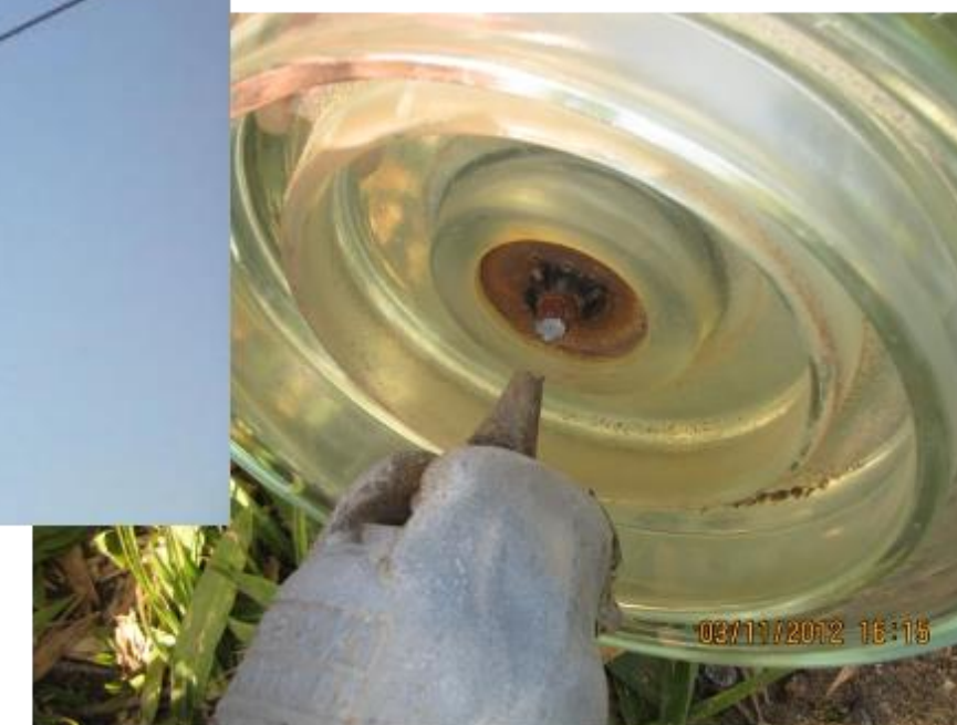
Corrosão no pino
