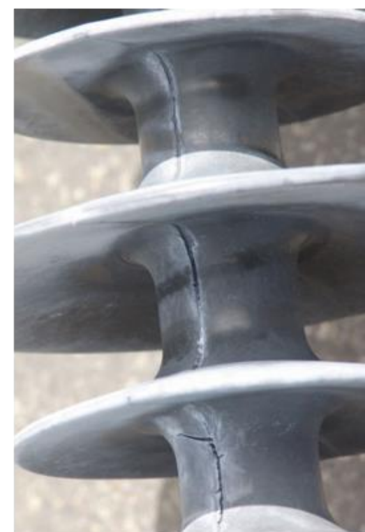
Fissura no revestimento
