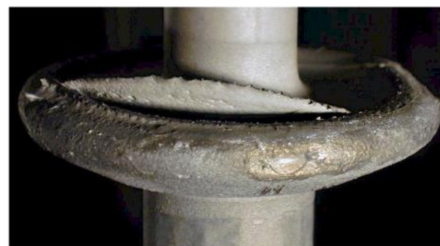
Descolamento do selo de vedação
