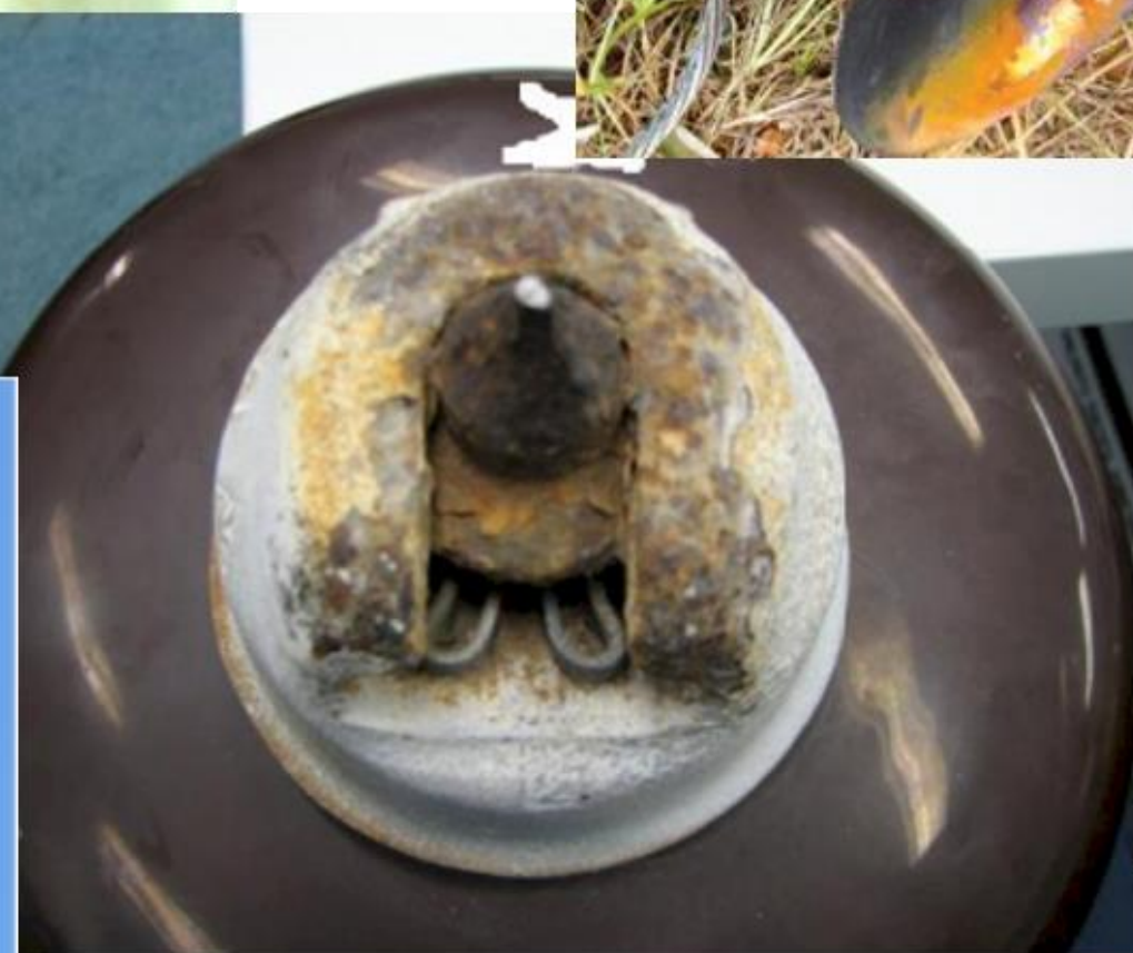
Corrosão do pino
