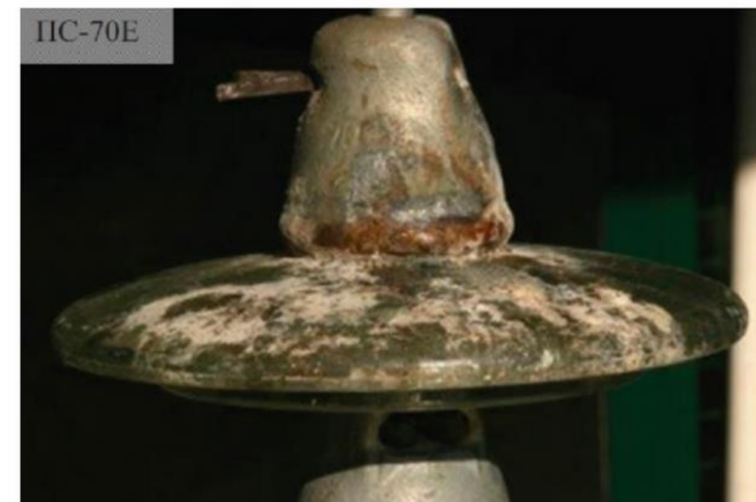
Corrosão por excremento de pássaros
