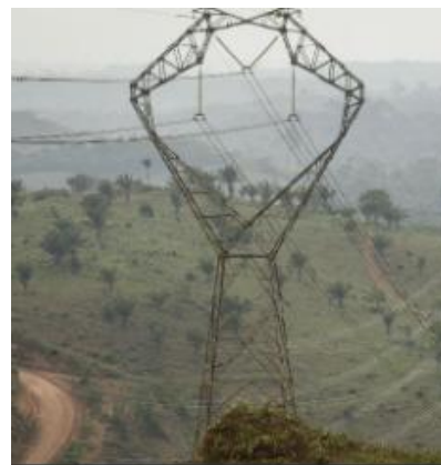
LT 230 kV – Eletronorte
